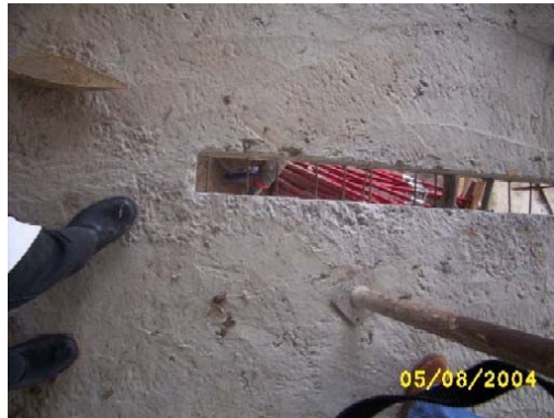
Figura 1- Abertura de laje sem proteção.
