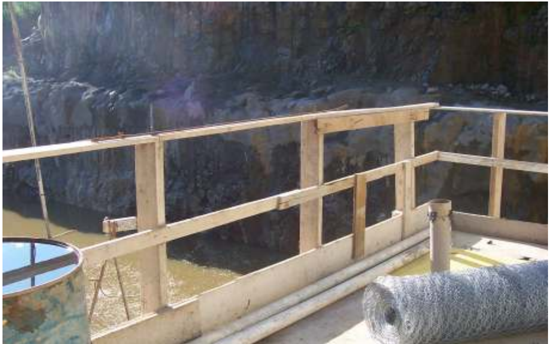
Figura 08 – Guarda-corpo provisório em madeira
