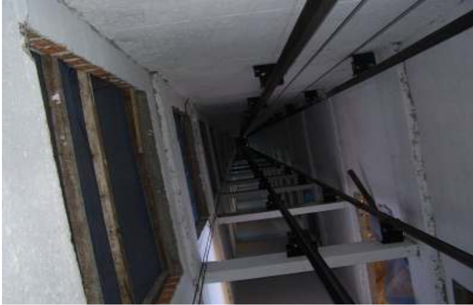
Figura 05 - Sistema de proteção com fechamento total da abertura (imagem interna do poço de elevador )
