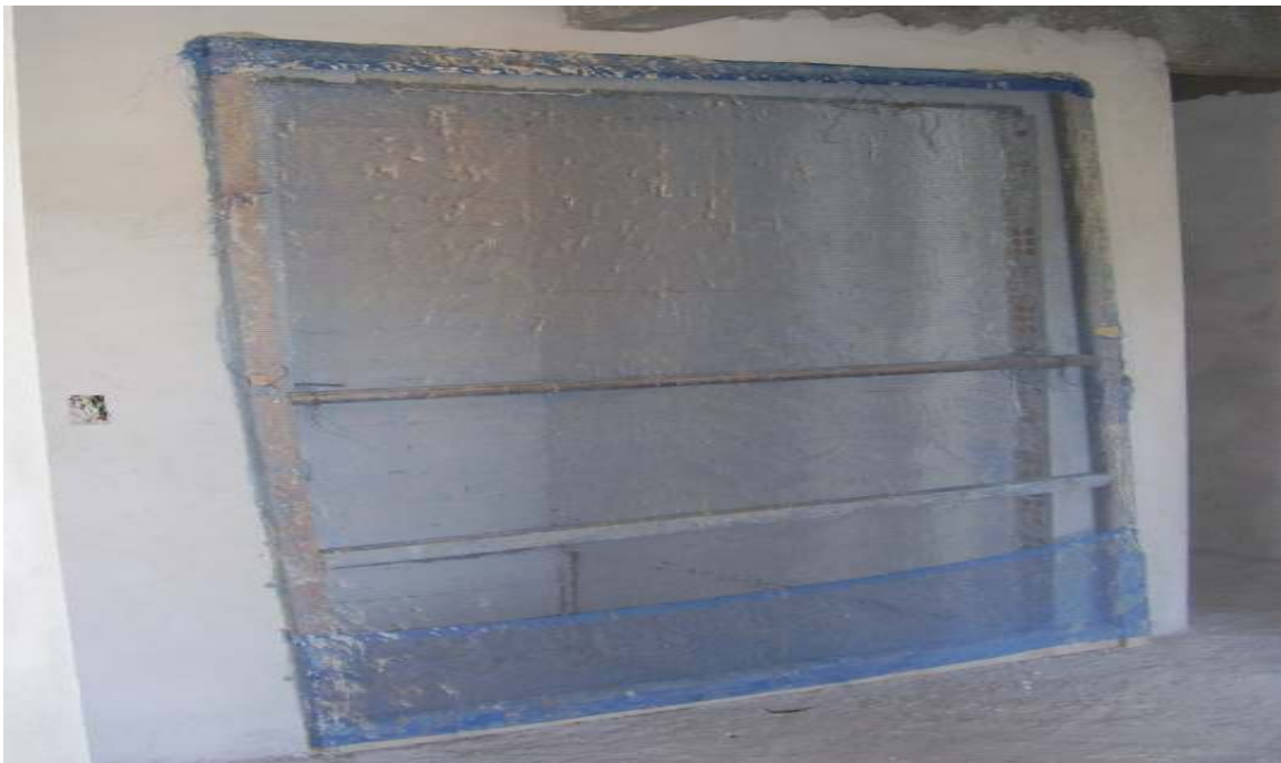
Figura 04 - Sistema de proteção com fechamento total da abertura
