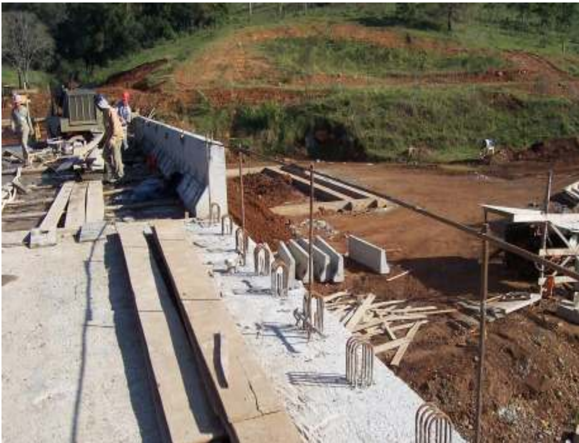
Figura 07 – Guarda-corpo definitivo em Concreto Armado
